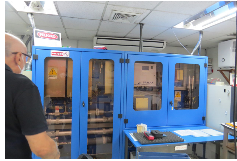
Equipo Spalax que procesa los gases.
